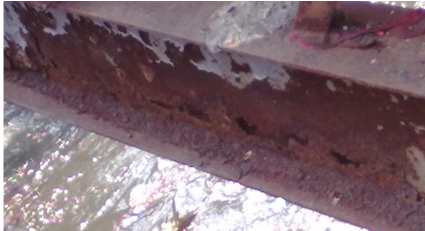
Gambar 2.18 Korosi seragam pada permukaan baja girder
